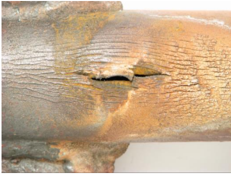
Resim 2.2. Isıl Yorulma Çatlağı (Kaynak: Kalluri vd., 2000)
