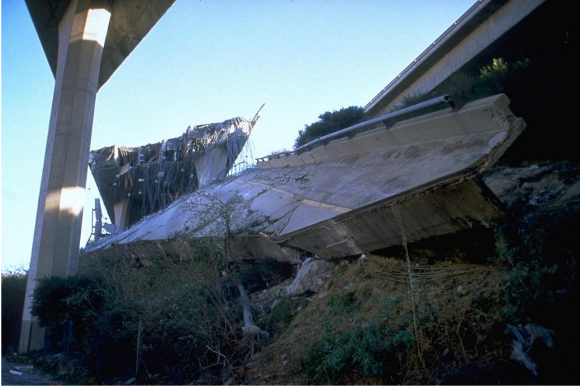
Resim 1.2. 1994 yılındaki Northridge depreminde meydana gelen yapısal göçme (Kaynak: Eplett, 1994)
