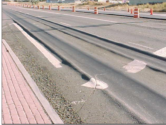
Şekil 2.12. Tekerlek izi oluşumu ve oluklanma
