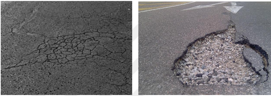
Şekil 2.8. Üstyapıda oluşan ayrışma(solda) ve çukur(sağda)
