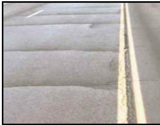
Şekil 2.7. Yol üstyapısında oluşan termal çatlaklar (Sönmez ve Taştan, 2018).
